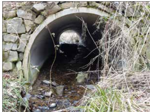
Abb 21: Kreisprofile sind die am meisten verwendeten Durchleitungsbauwerke. Sie eignen sich am Ehesten für kleine Gewässer.
