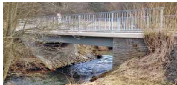
Abb. 7: Brücke nach Fertigstellung. Das Freihalten des Abflussquerschnittes gehört zu den Aufgaben des Unterhaltungspflichtigen
