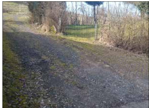
Abb. 7: Ausspülung mit Regenwasser.
