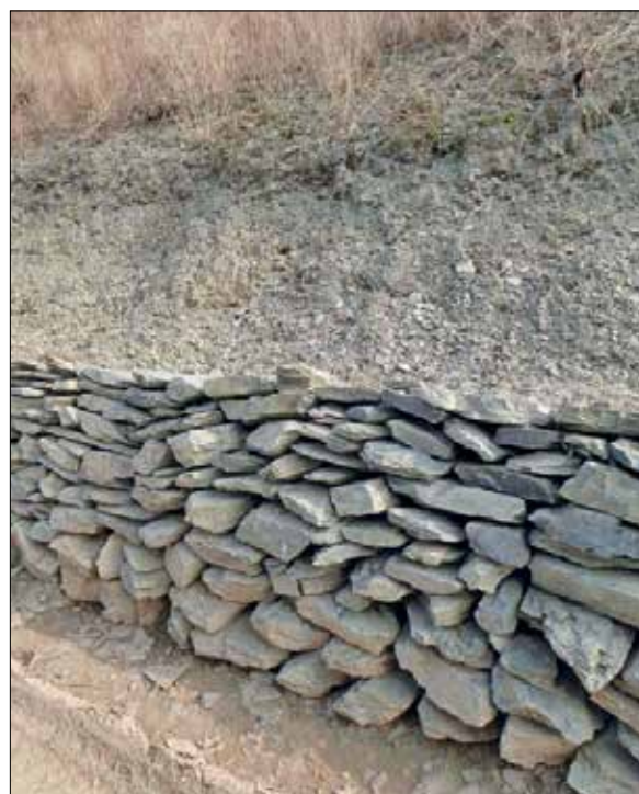
Abb. 5: Futtermauer, Wehlen (DLR Mosel)
