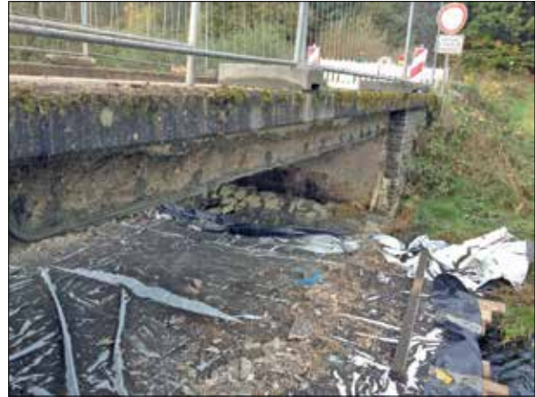
Abb. 5: Beim Arbeiten muss eine Verschmutzung des Gewässers vermieden werden, insbesondere der Eintrag von Zementleim oder wassergefährdenden Treib- und Schmierstoffen. Behelfskonstruktionen während der Bauzeit müssen abschwemmungssicher sein.
