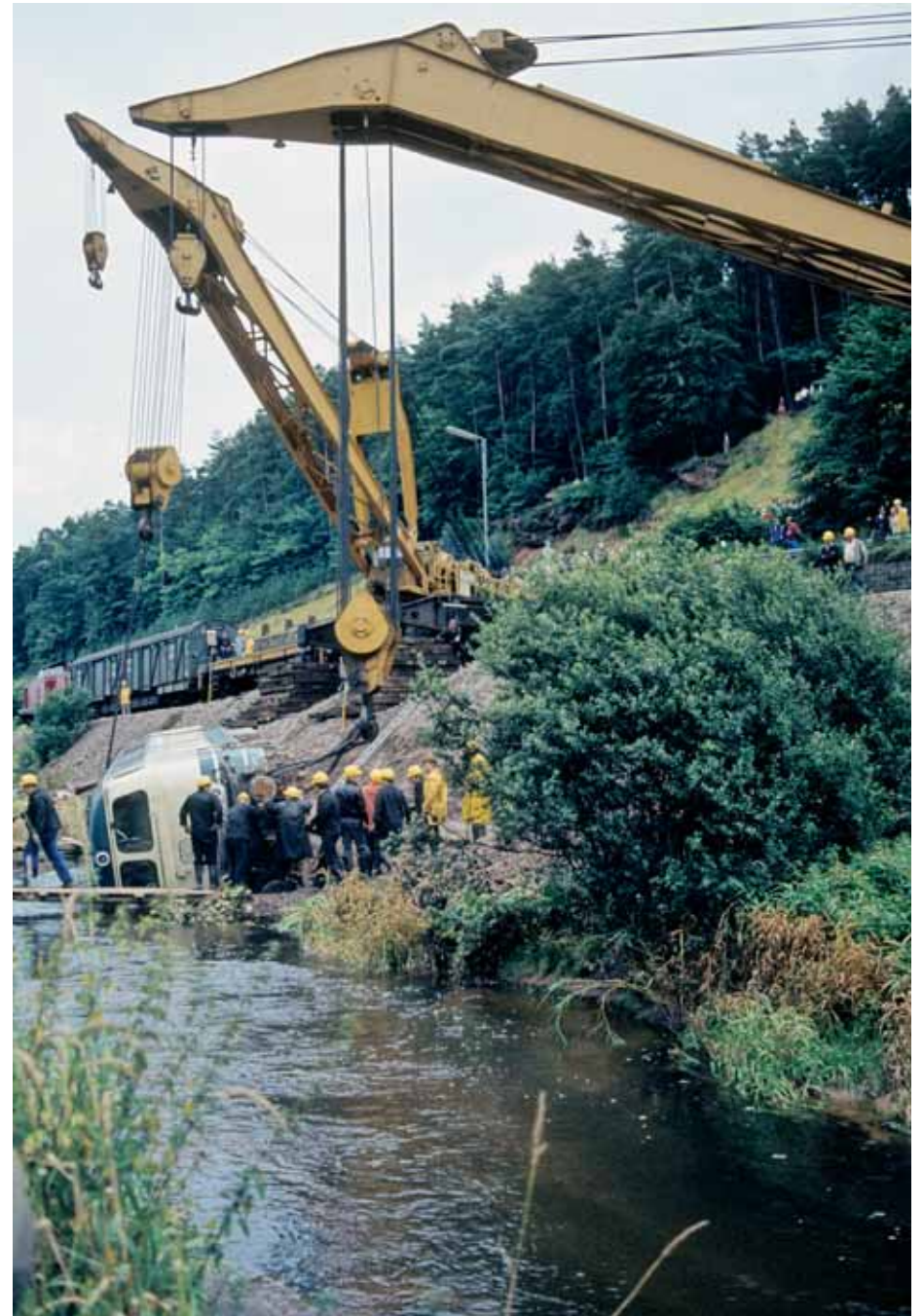
Nach einem Dammrutsch entgleiste Diesellok 218 384 bei Schopp und konnte erst nach sorgfältiger Vorbereitung geborgen werden. Klaus Franck beobachtete am 30 August 1980 die Arbeiten.
