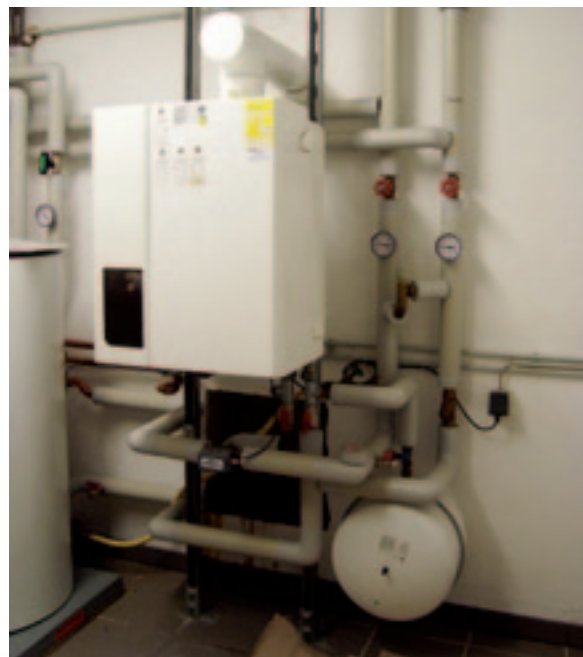
Abb. 43: Bestandsaufnahme einer erneuerten Heizungsanlage (eigene Aufnahme)
