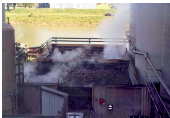
Abb. 17: Emissionen eines Biofilters
