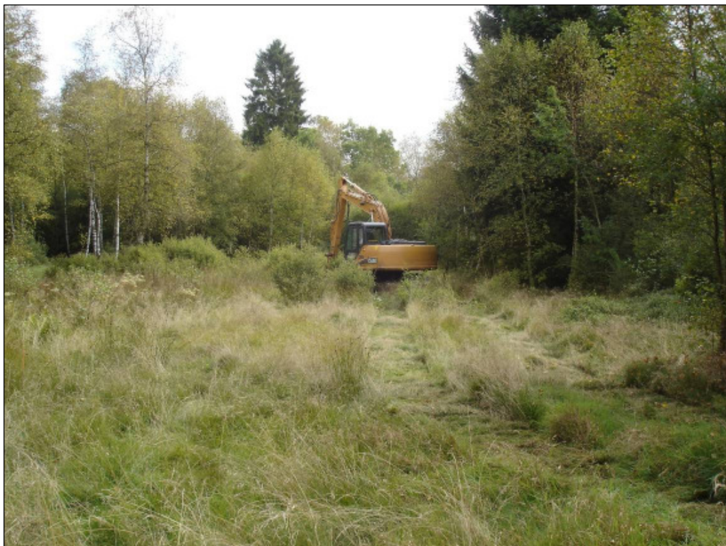
Zone 2 vor der Restaurierung
