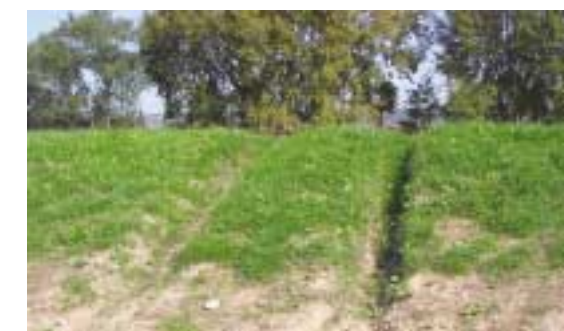
Das unnötige Befahren oder Begehen der Deiche und deren Böschungen führt schnell zu einer Schwächung der Standsicherheit.
