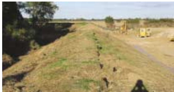
Risse kündigen Rutschungen an und lassen auf eine Schwächung der Standsicherheit schließen.
