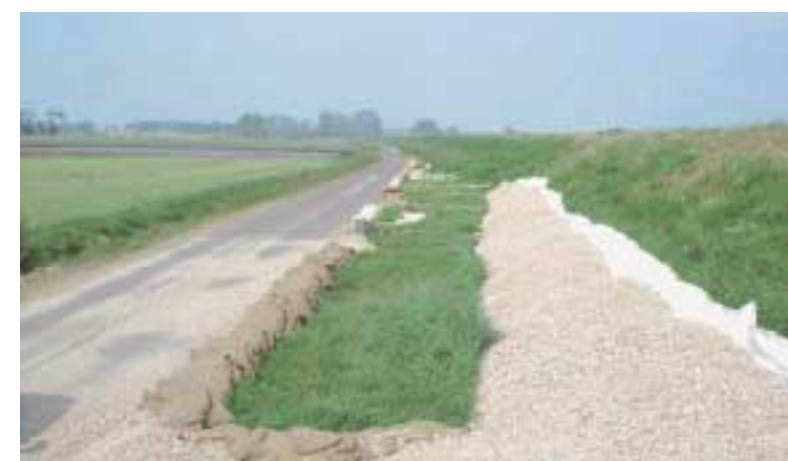
Der durchweichte Deichfuß wird mit einer Filtermatte abgedeckt und mit Kies beschwert (Auflastfilter). Der Sickerwasserabfluss ist somit nicht behindert und der Deichfuß stabilisiert.
