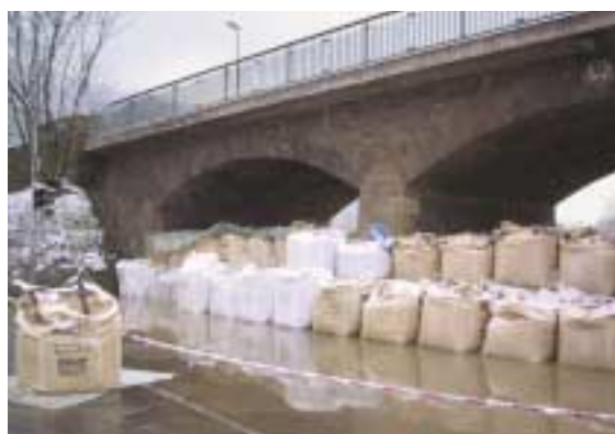
Einsatz von Big Bags zur provisorischen Sicherung einer Durchfahrt in Miltenberg am Main.
