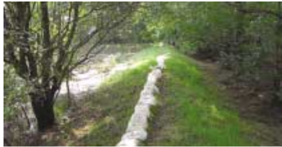
Zu schmale Deichkronen und Bewuchs führen zu einer stärkeren Durchsickerung und Materialaustrag.
