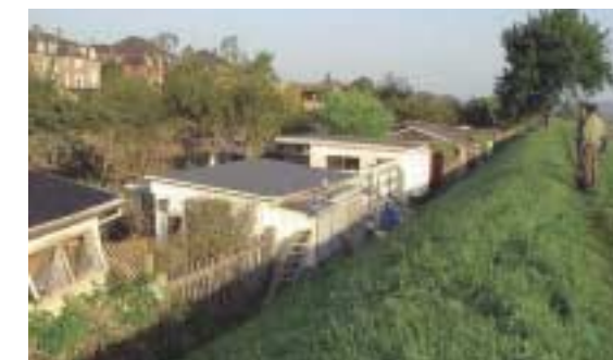
Zu nahe Bebauung am Deich verhindert die Kontrolle und erhöht bei Einbauten im Untergrund die Durchsickerung. Sickerwasseraustritte werden gar nicht oder zu spät erkannt. Die Deichverteidigung wird erschwert.
