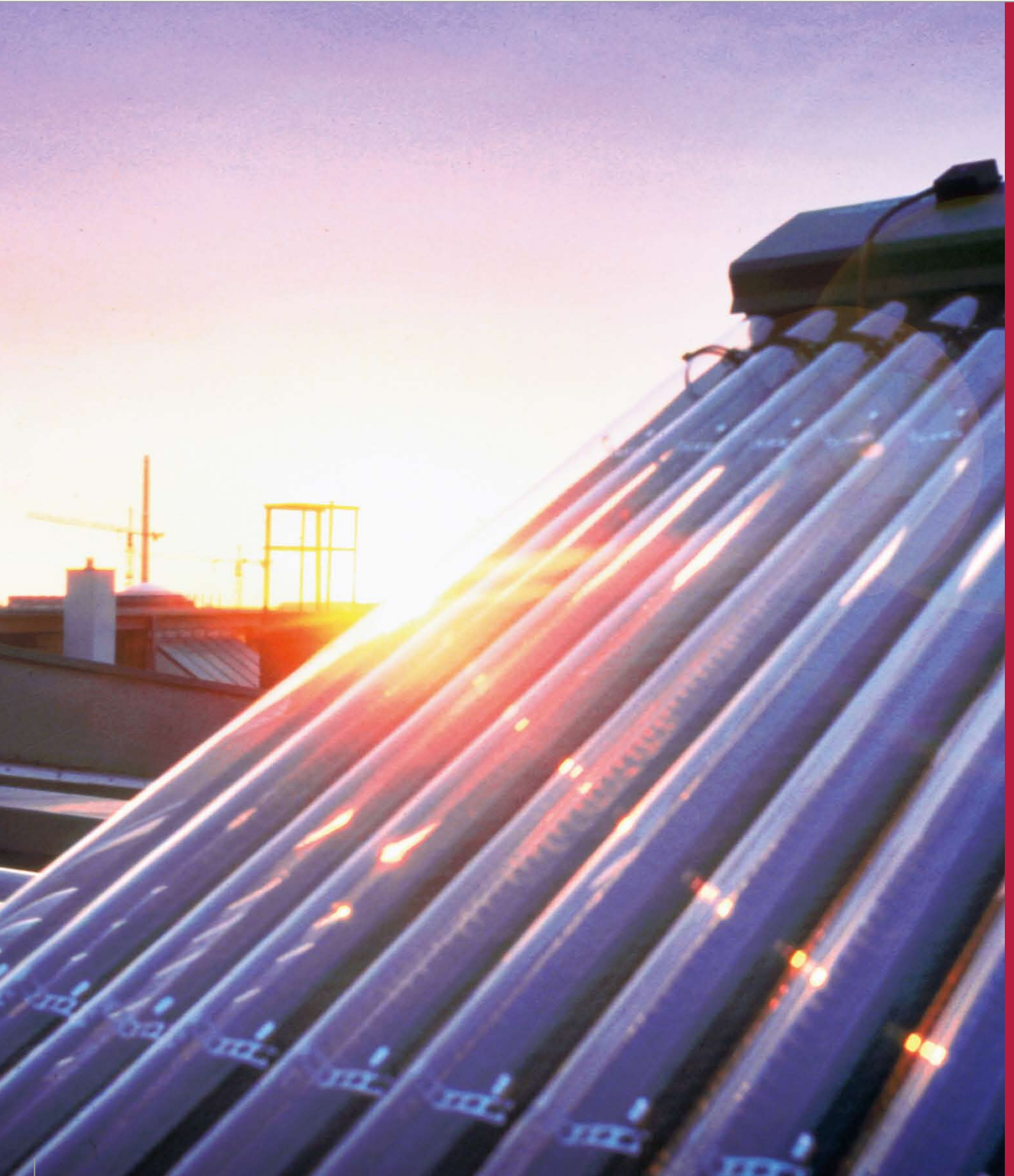
Solarwärmanlage – eine energieeffiziente Lösung
